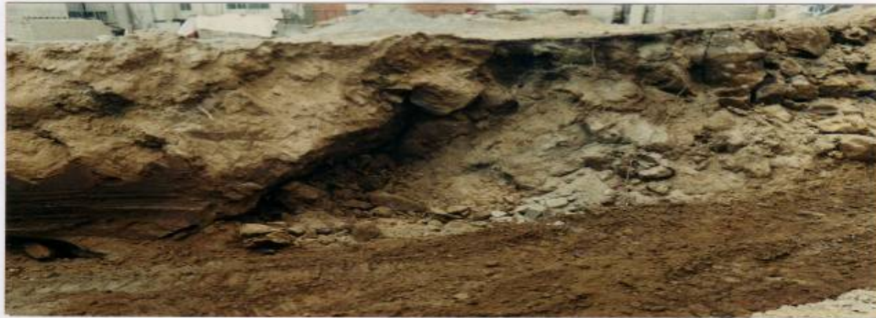
FALLA Ó GRIETA EN EL TERRENO.
